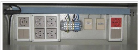
Fig. 4 : Bandeja eléctrica con bornera
