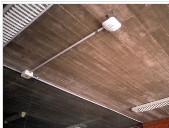
Fig. 1 - AP Aruba fijado a cielorraso común
