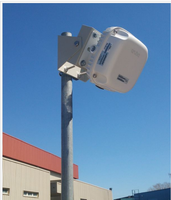
Fig. 1 - Equipo Aruba AP-367-RW fijado a caño
