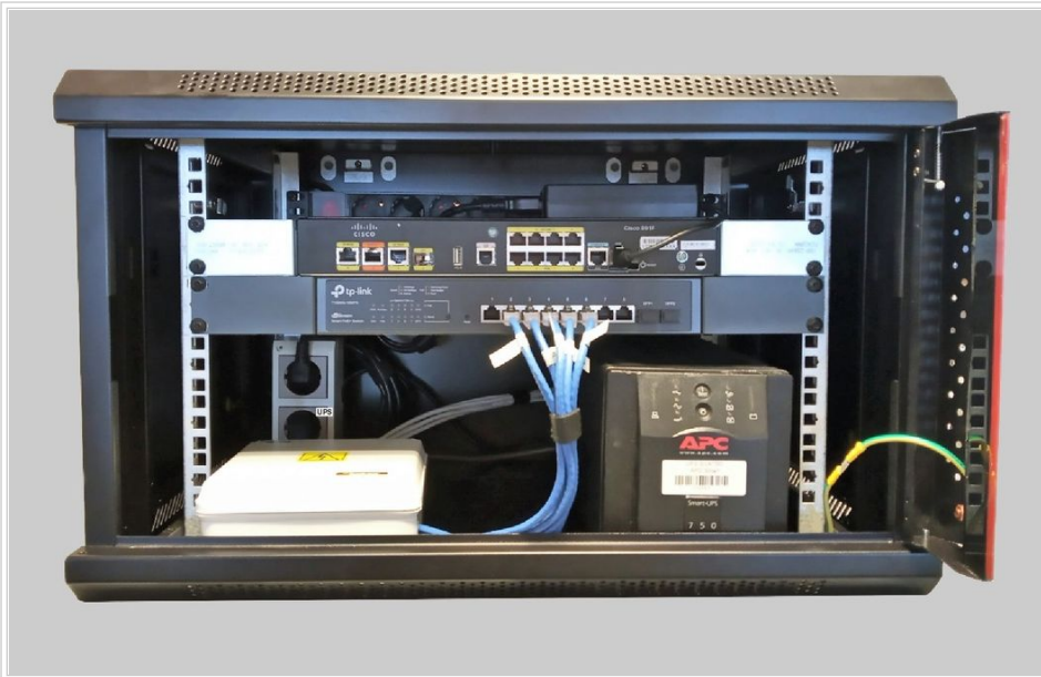
Fig. 4 : Disposición de equipos en rack 6U
