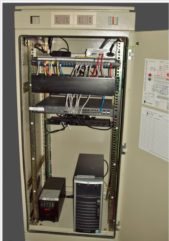
Fig. 3 : Interior de rack
