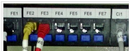
Fig. 6 - Rotulado en patchera
