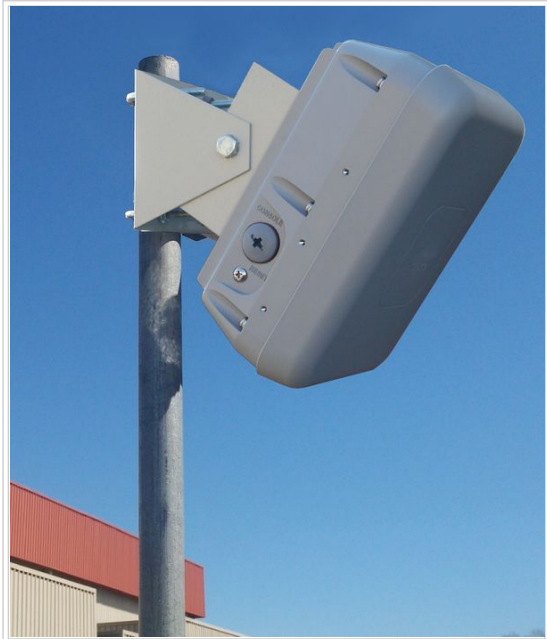
Fig. 1 - Equipo Cisco 1562-D fijado a caño
