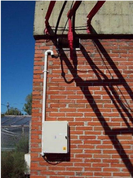
Fig. 9 – Tablero para fuentes de equipos
