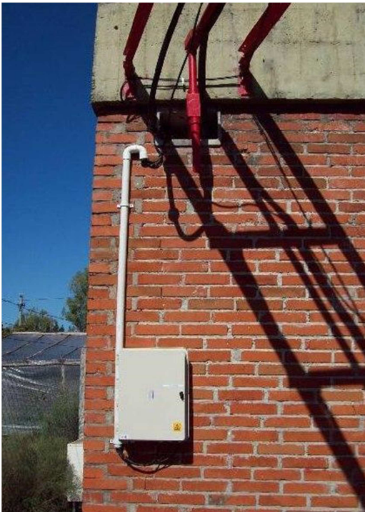
Fig. 9 – Tablero para fuentes de equipos
