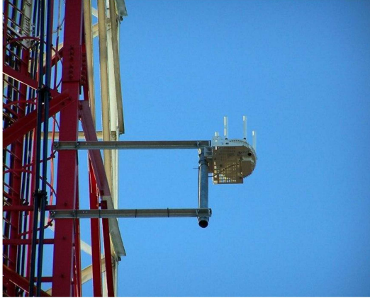
Fig. 7 – Equipo en torre
