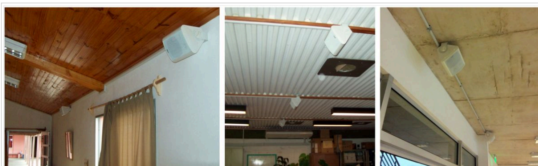
Fig. 10 : Ejemplos de instalación de parlantes.
