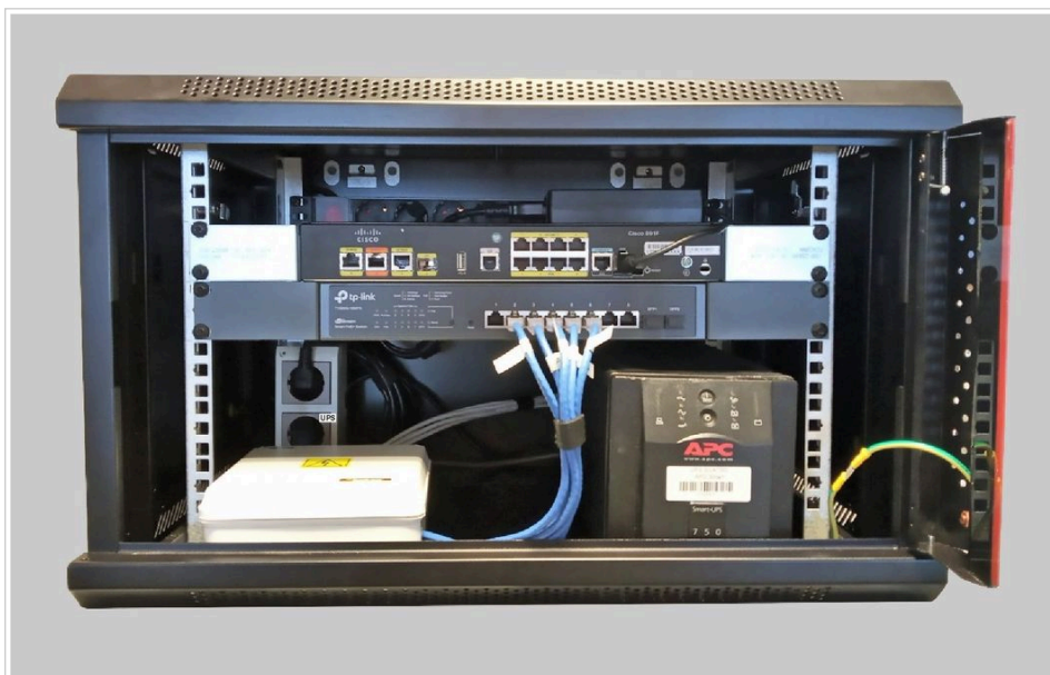
Fig. 4 : Disposición de equipos en rack 6U
