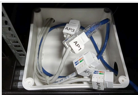
Fig. 5 : Interior de caja con jacks
