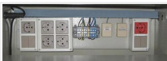
Fig. 4 : Bandeja eléctrica con bornera
