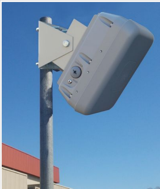
Fig. 1 - Equipo Cisco 1562-D fijado a caño
