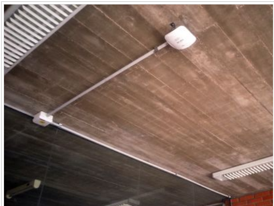
Fig. 1 - AP Aruba fijado a cielorraso común
