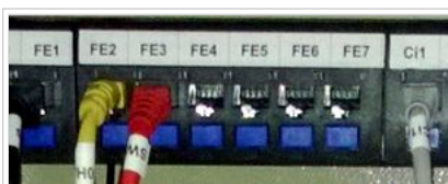
Fig. 6 - Rotulado en patchera
