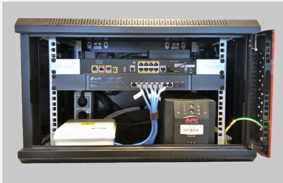
Fig. 4 : Disposición de equipos en rack 6U
