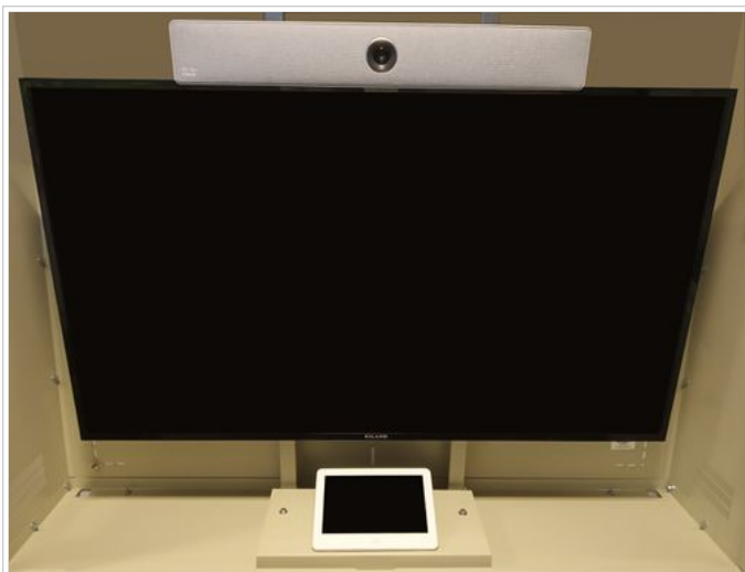
Fig. 1 : Equipo Room Bar instalado en gabinete VC desarmable
