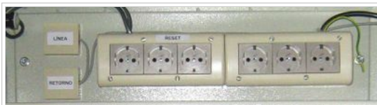
Fig. 6 : Bandeja eléctrica sin bornera
