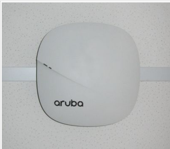
Fig. 3 - AP Aruba fijado a cielorraso tipo Armstrong
