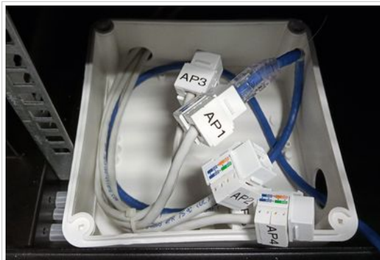
Fig. 5 : Interior de caja con jacks
