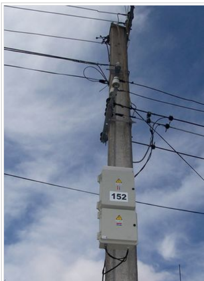
Fig. 1 Gabinete con AP y antena integrada.
