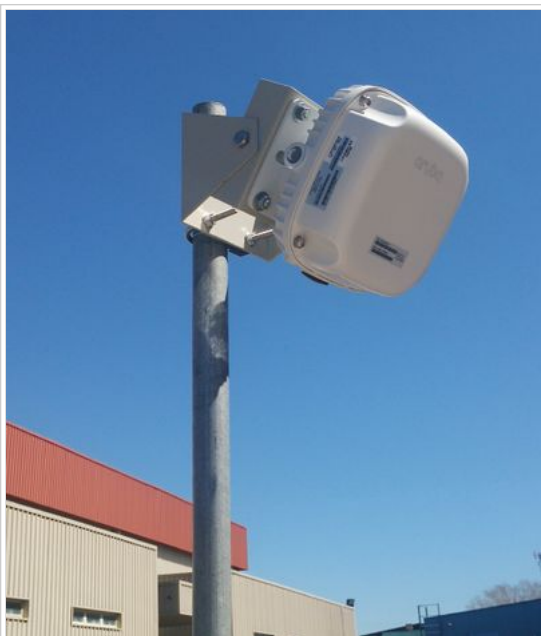
Fig. 1 - Equipo Aruba AP-367-RW fijado a caño
