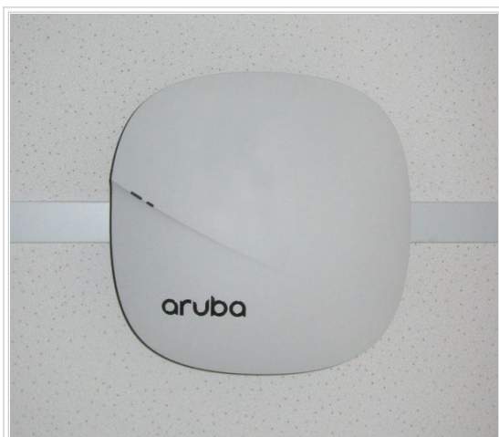
Fig. 3 - AP Aruba fijado a cielorraso tipo Armstrong
