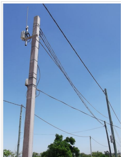
Fig. 2 AP con antena exterior en postación ANTEL.
