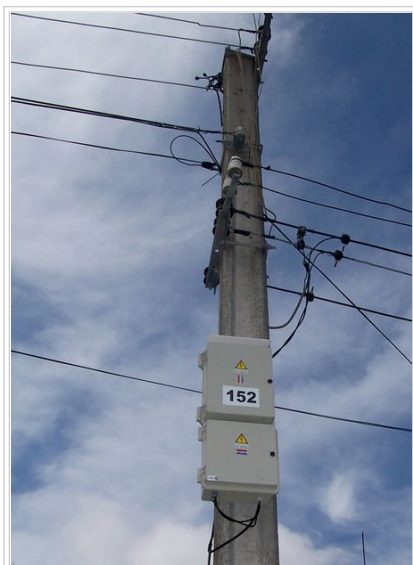
Fig. 1 Gabinete con AP y antena integrada.
