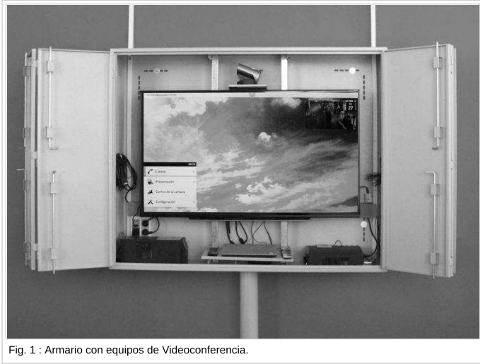
Fig. 1 : Armario con equipos de Videoconferencia.
