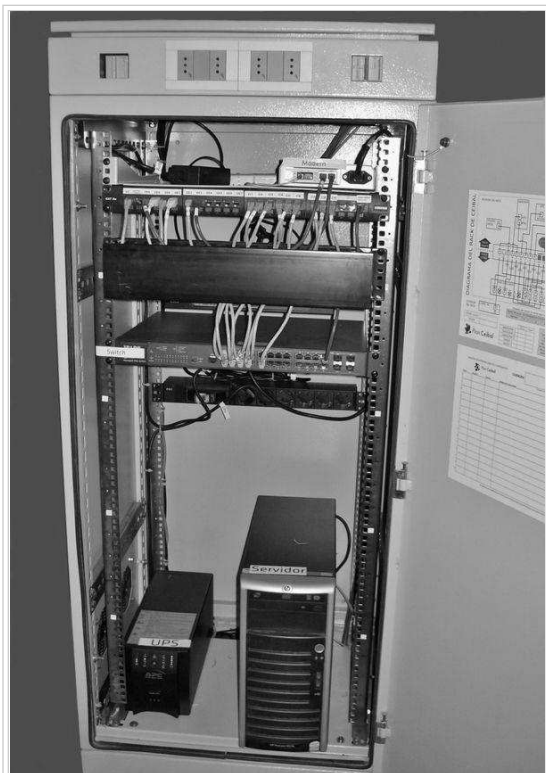
Fig. 3 : Interior de rack
