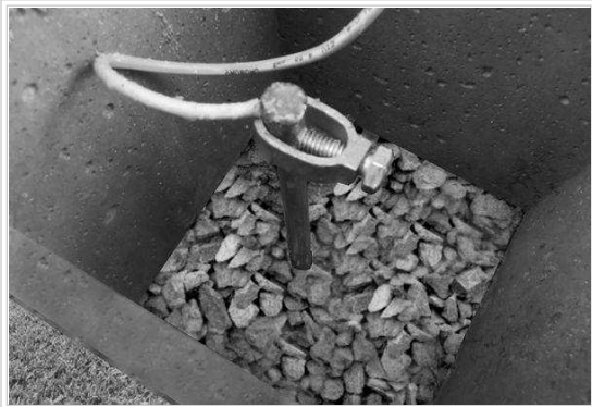
Fig. 2 : Cámara de puesta a tierra
