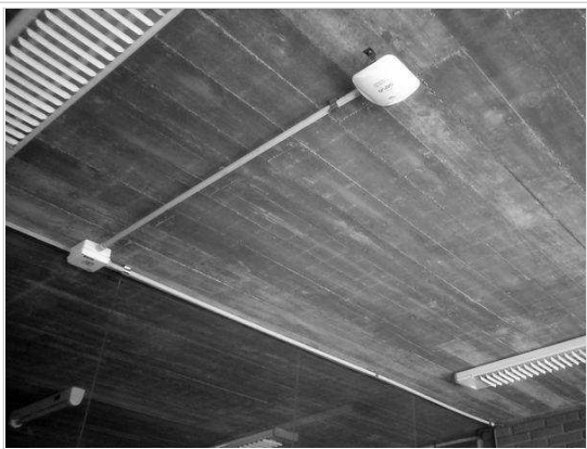
Fig. 1 - AP Aruba fijado a cielorraso común
